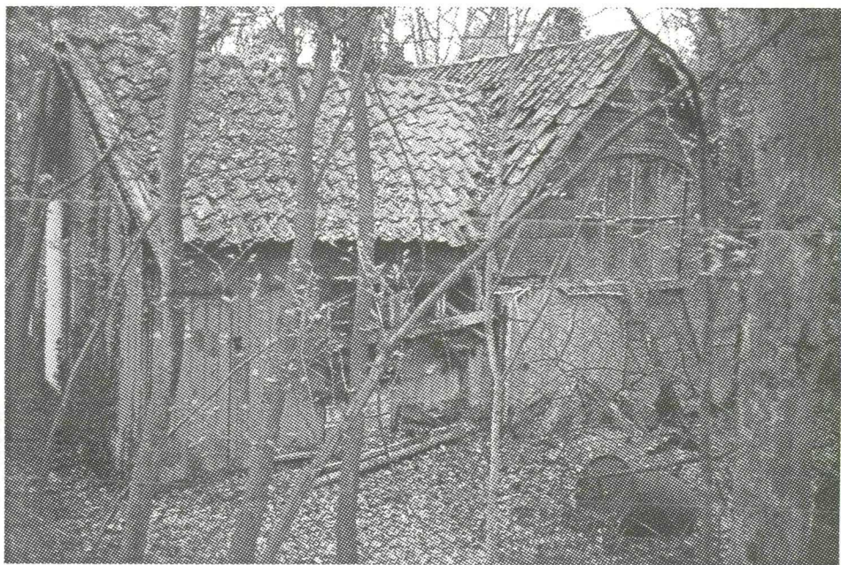
De woning van kunstschilder Matthijs Hage (1882-1961) in het bos op Goyergracht Zuid 13 in Eemnes. Het pand is niet meer bewoond en verkeert in vervallen staat.
